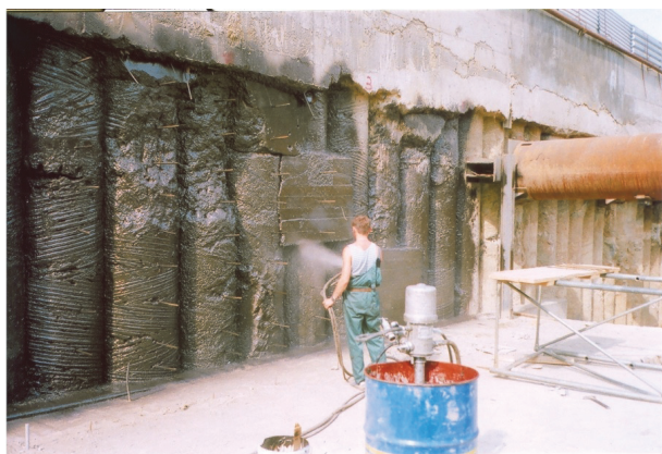
Рисунок 1 – Гидроизоляция опорной стены рампы автомобильного тоннеля на пересечении улиц Шереметьевская и Сущевский вал. г. Москва.
